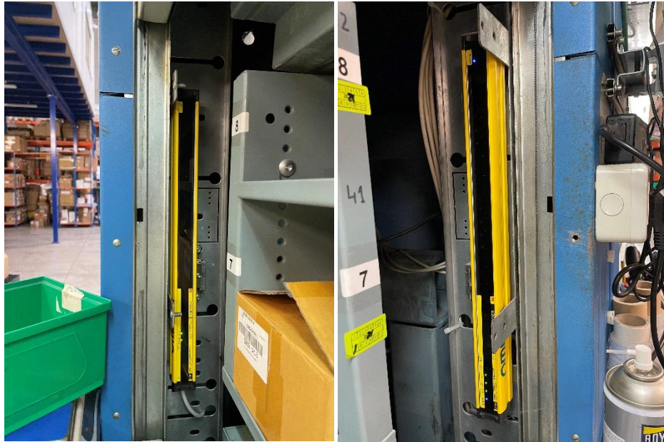
Figura 36. Barrera de seguretat del magatzem intel·ligent de Dismuntel
