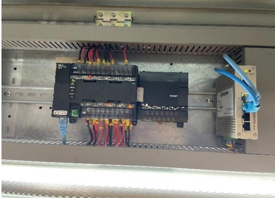
Figura 38. PLC i switch del magatzem intel·ligent
