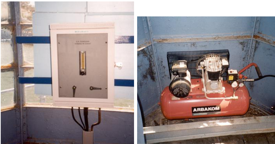
Figura 24. Limnómetro de burbujeo, compresor y medidor de nivel de la presa de Gasset.
