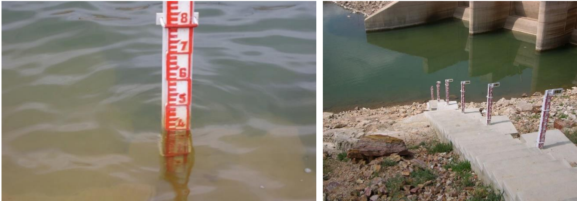
Figura 23.. Escala limnimétrica para la medición del nivel de agua en un embalse. Presa Vega Jabalón y Vallehermoso.
