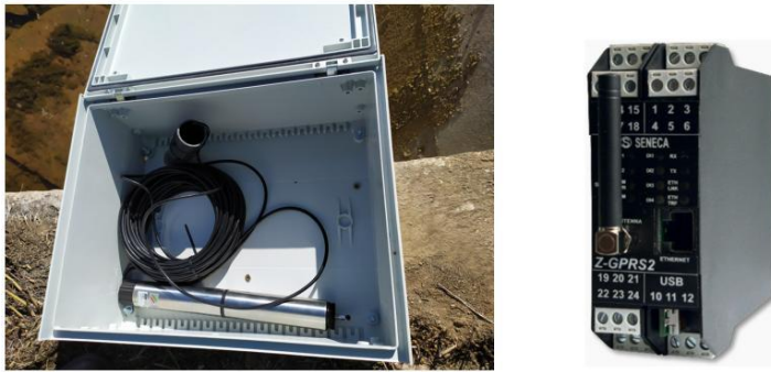
Figura 3: Sonda piezorresistiva y arqueta para instalación del dispositivo de transmisión de datos (datalogger).
