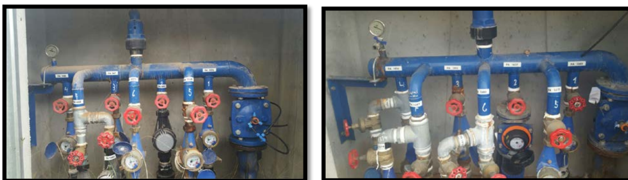
Figura 6: Hidrantes multiusuario con 1 toma desdoblada (izq.) y con 3 tomas desdobladas (der.)
