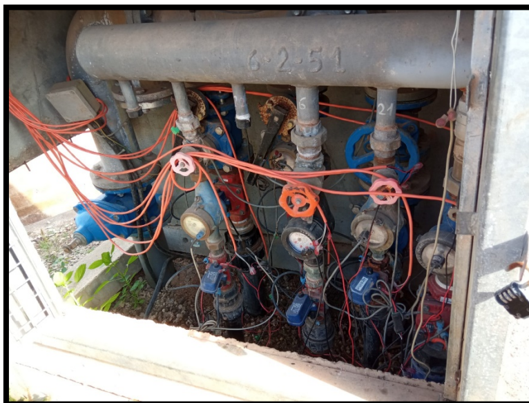
Figura 7: Hidrante multiusuario con exceso de tomas y elementos singulares.
