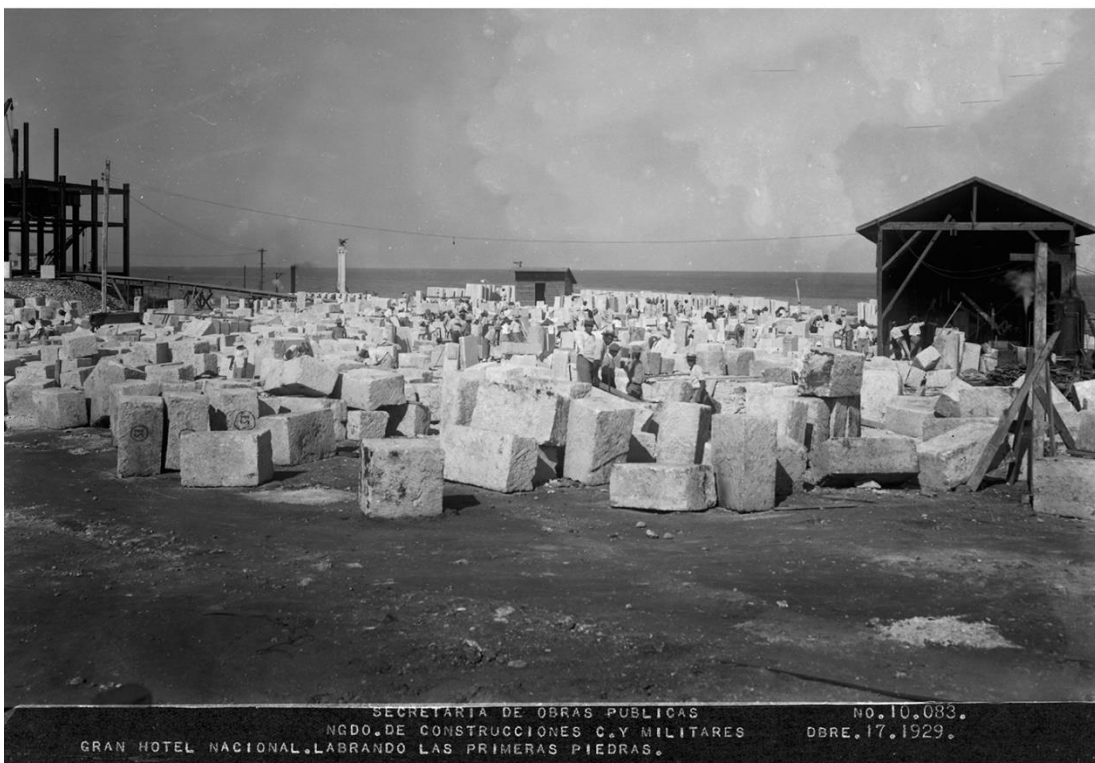
Fotos del proceso para levantar estructura de acero, además del labrado de las primeras piedras para el Hotel Nacional, 1929. Secretaría de Obras Públicas - Negociado de Construcciones Civiles y Militares, La Habana, 1929.
