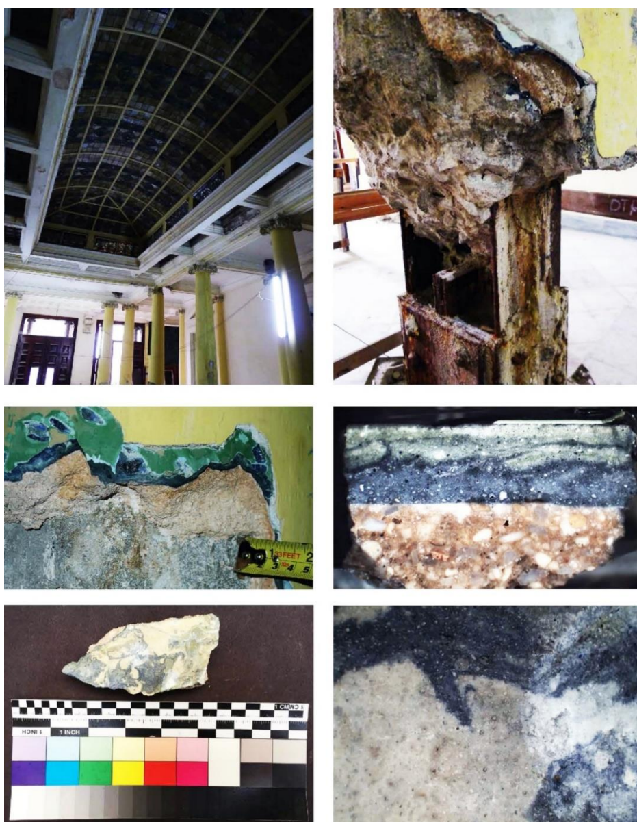
Vistas del interior del antiguo banco y estudios microscópicos de los acabados de la columna investigada mostrando la técnica de la escayola. Fotos por Pantel del Cueto & Asociados LLC, 2018; y cortesía del Laboratorio de Tecnología de Preservación de Columbia University.
