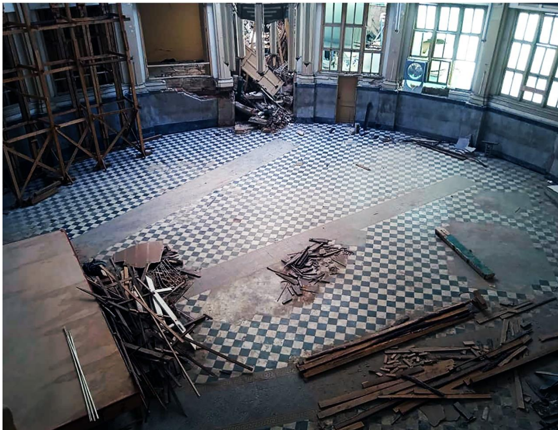
Condición del techo en forma de cono original del antiguo circo, e interior luego de la explosión. Cortesía de la historiadora Yamira Rodríguez Marcano de la empresa RESTAURA Oficina del Historiador de la ciudad de La Habana, 2022.
