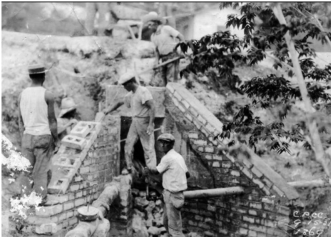
Obreros utilizando cemento Pórtland para construir una tajea en Mariel, Cuba. Colección fotos históricas RESTAURA, Oficina del Historiador de la Ciudad, La Habana.
