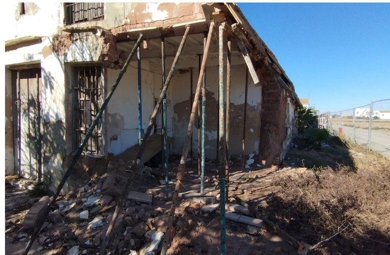
Fig 124. Parte donde se ha perdido el muro. Fuente: Carlos Fuster Aparisi
