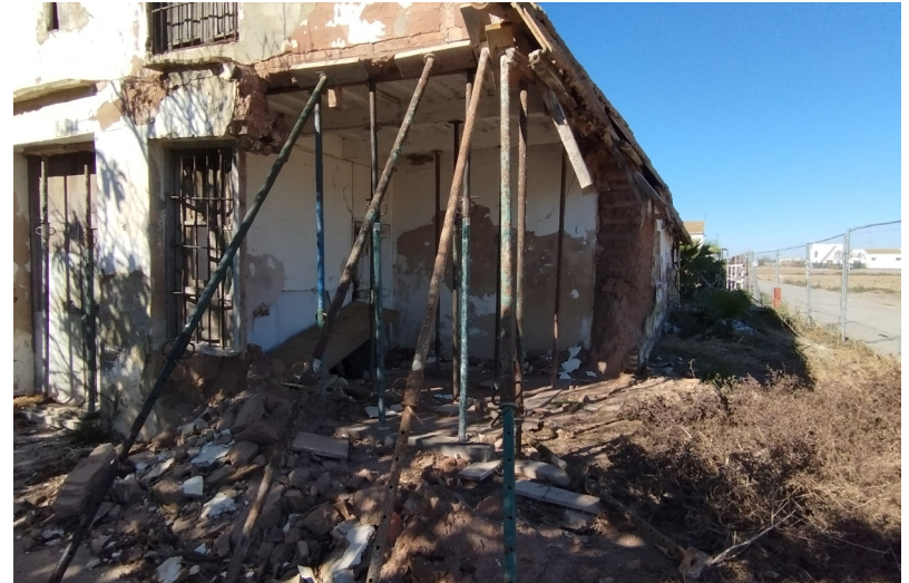
Fig 130. Imagen de la parte de muro perdido. Fuente: Carlos Fuster Aparisi
