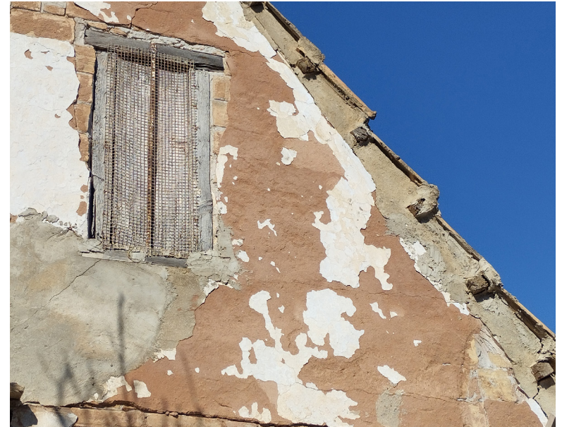
Fig 127. Desconchado en la fachada este. Fuente: Carlos Fuster Aparisi
