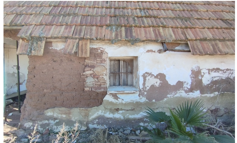
Fig 126. Imagen de la fachada norte donde se observa el deterioro del muro. Fuente: Carlos Fuster Aparisi
