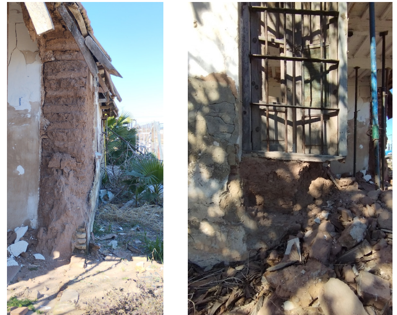
Fig 128. Erosión del muro. Fuente: Carlos Fuster Aparisi
