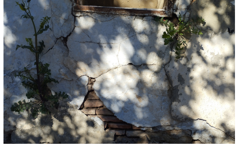
Fig 132. Vegetación que ha crecido en fachada. Fuente: Carlos Fuster Aparisi.
