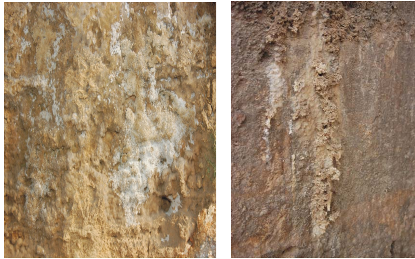
Figura 7.2. Material pétreo Tosca de Rocafort. Eflorescencia.
