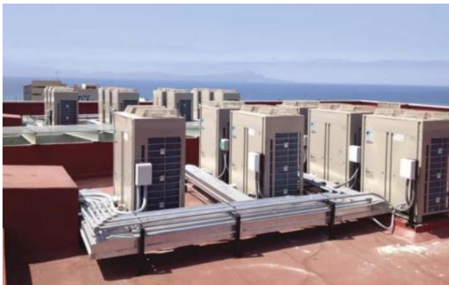
Ilustración 15. Varias unidades exteriores VRF en la cubierta de un edificio.
