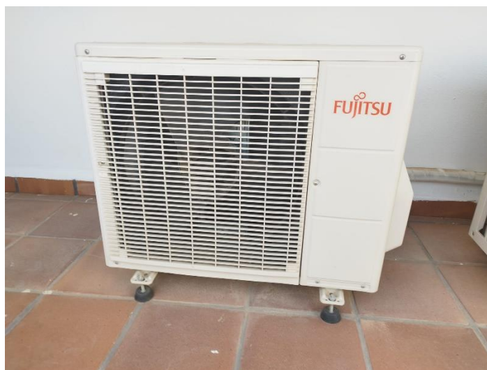
Ilustración 26. Unidad exterior de un Split 1x1 sobre soportes antivibratorios.
