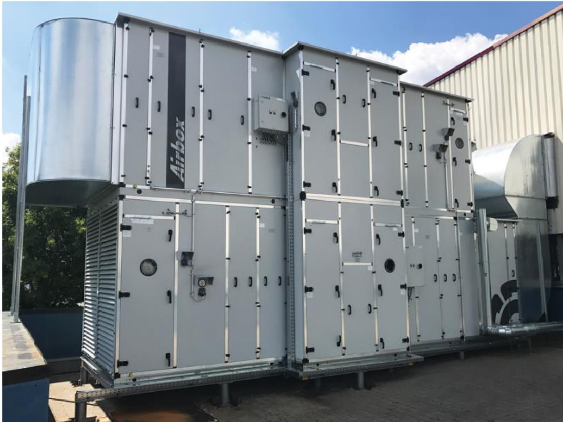
Ilustración 25. Uta colocada en un edificio.
