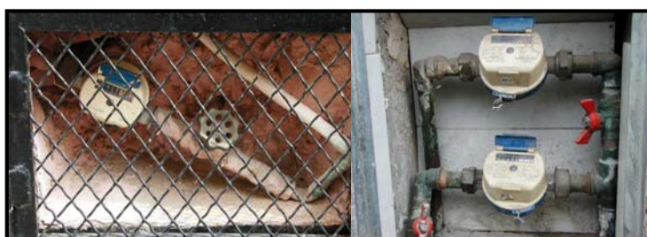
FIGURA 1. INSTALACIÓN INCLINADA DE LOS CONTADORES DE AGUA.
