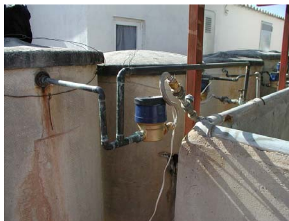
FIGURA 6. PRESENCIA DE DEPÓSITOS DE ALMACENAMIENTO EN LAS INSTALACIONES INTERIORES
