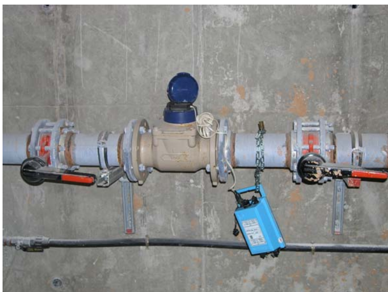
FIGURA 1. INSTALACIÓN DE UNA CONTADOR WOLTMAN JUNTO A UNA VÁLVULA DE MARIPOSA.
