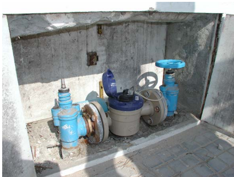
FIGURA 5. INSTALACIÓN DE UNA CONTADOR DE CHORRO ÚNICO JUNTO CON UNA VÁLVULA DE COMPUERTA AGUAS ARRIBA SIN MANTENER TRAMOS RECTOS DE TUBERÍA.
