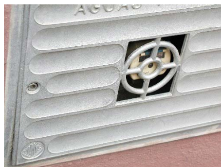
FIGURA 1. INSTALACIÓN INAPROPIADA DE CONTADORES EN PARED Y BATERIA
