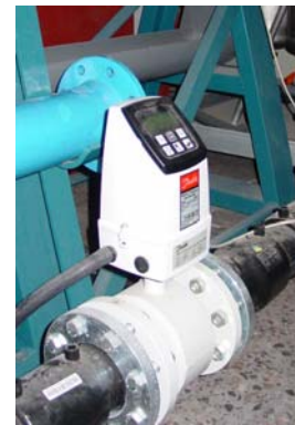
FIGURA 5. CAUDALÍMETRO ELECTROMAGNÉTICO DE REFERENCIA.
