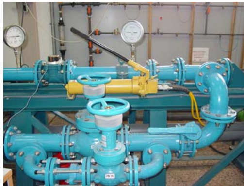
FIGURA 8. VÁLVULAS DE REGULACIÓN DE LOS CAUDALES DE ENSAYO.
