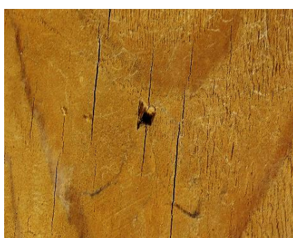
Figura 67. Detalle de las fisuras del reverso.
