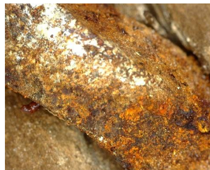
Figura 71. Detalle del clavo oxidado del travesaño.
