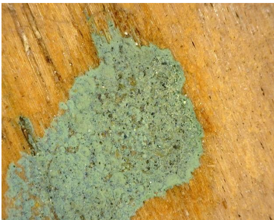
Figura 91. Detalle de la mancha de pintura.
