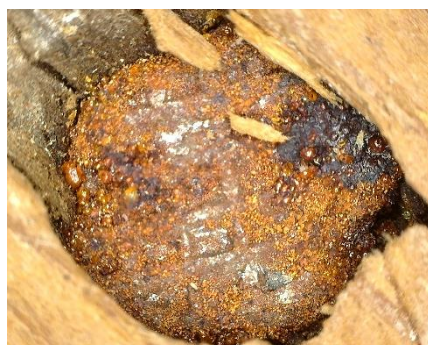
Figura 70. Detalle de la cabeza del clavo oxidada.
