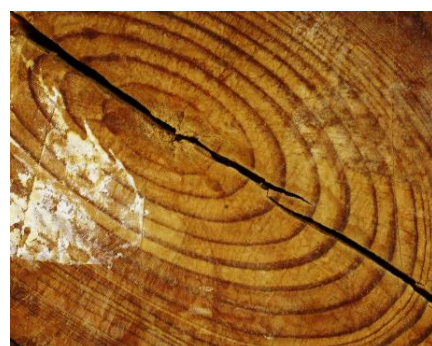
Figura 66. Detalle de la grieta en el nudo.
