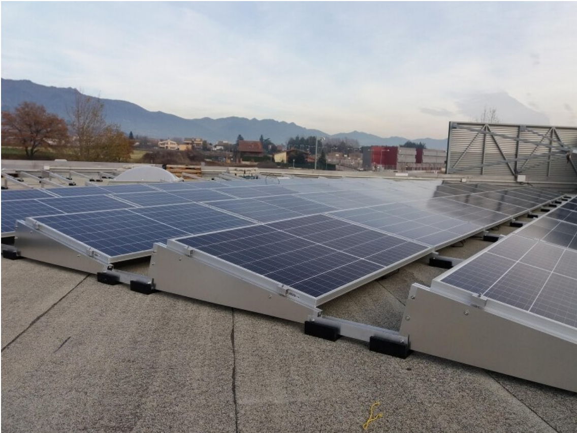
Ilustración 24 Ejemplo de Instalación PICOS 4.0 Fuente: AlusinSolar
