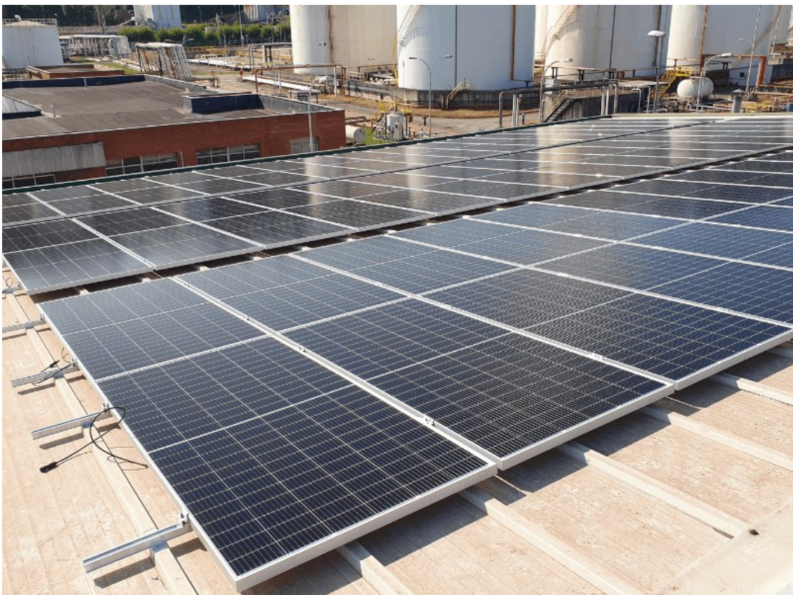
Ilustración 26 Ejemplo de Instalación GULPIYURI 30 Fuente: Alusin Solar
