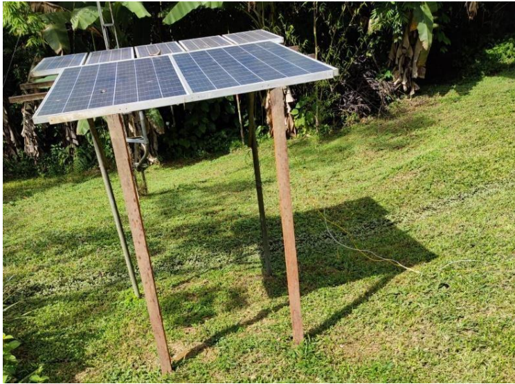
Figura 6: Antigua instalación fotovoltaica que fue reubicada
