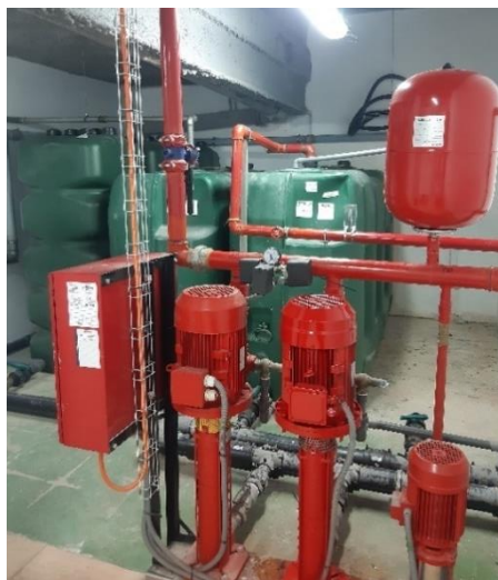
Ilustración 20 - Despóticos, calderín y bombas de presión contra incendios (Elaboración propia, 2023).
