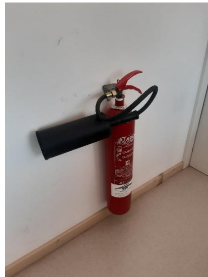
Ilustración 22- Extintor de CO 2 ubicado en la escalera de la primera planta (Elaboración propia, 2023)
