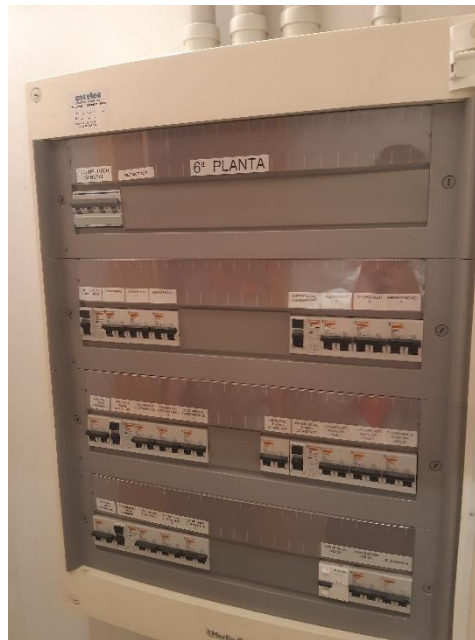
Ilustración 12 - Cuadro eléctrico secundario de la sexta planta (Elaboración propia, 2023).
