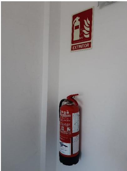
Ilustración 21 -Extintor tipo ABC situado en la escalera de la cuarta planta (Elaboración propia, 2023)
