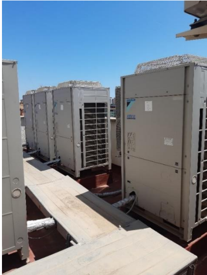
Ilustración 19- Sistemas VRV instalados en la terraza (Elaboración propia, 2023)
