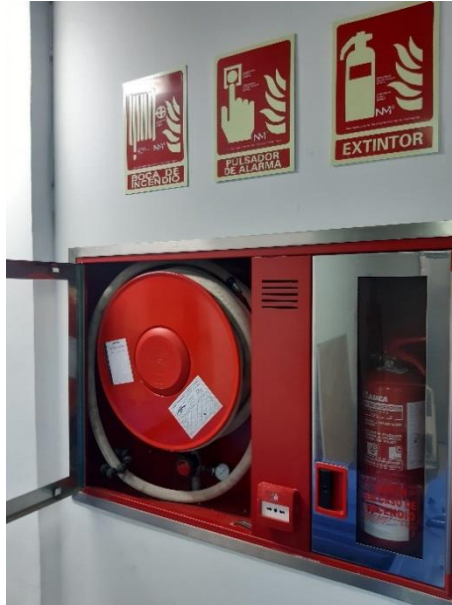
Il·lustració 23- Boca de Incendi Equipada instal·lada en el sòtano del edifici (Elaboració pròpia, 2023)
