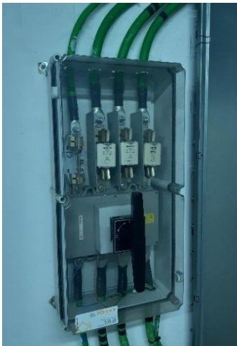
Ilustración 5 – Fusibles de línea del transformador al cuadro general (Elaboración propia, 2023)
