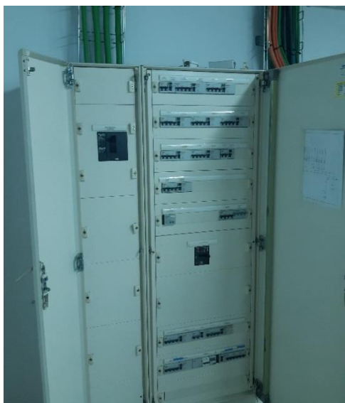
Il·lustració 9 - Cuadro general eléctrico (Elaboración propia, 2023).
