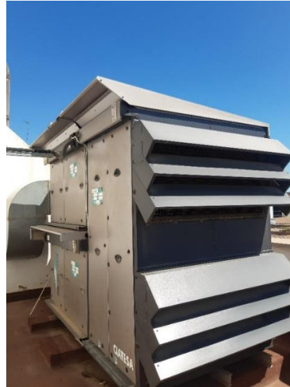
Ilustración 18- Unidad de tratamiento de aire instalada en la terraza (Elaboración propia, 2023)
