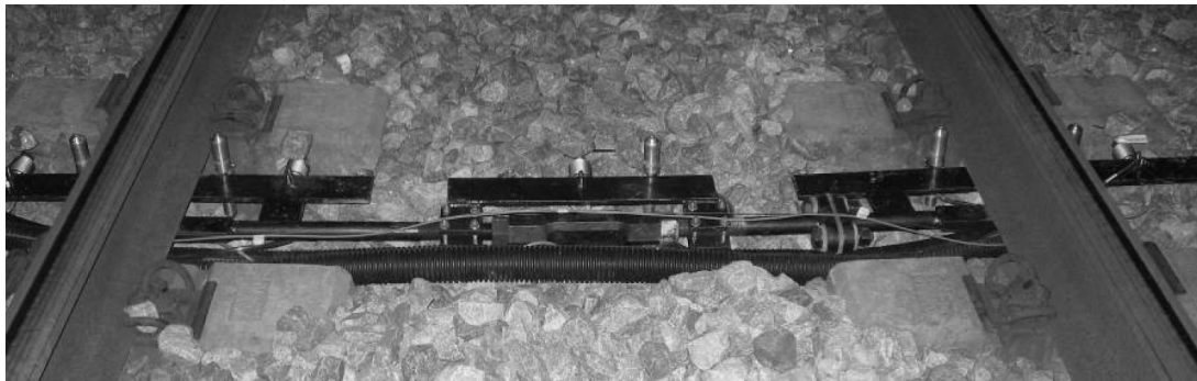
Figura 8: Instrumentación sobre capa de balasto, a excepción de sonda cobra. Fuente: [3]
