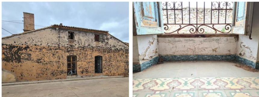
Figura 81. Humedades por capilaridad. 2023. Fuente: propia.
