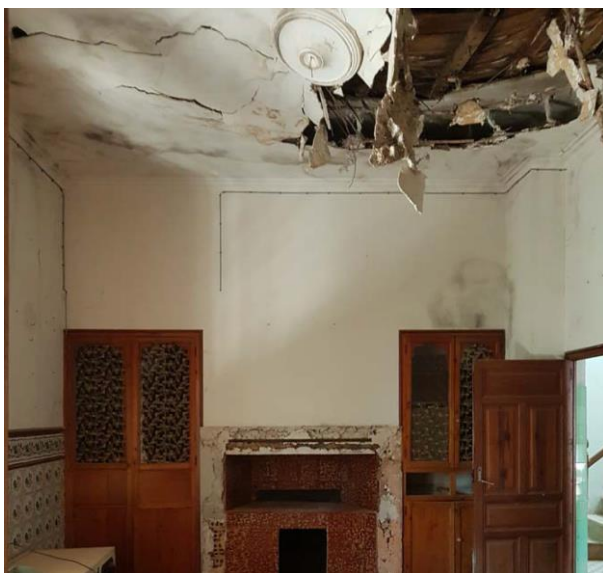
Figura 78. Paño con viguetas con flecha excesiva. 2023. Fuente: propia.
