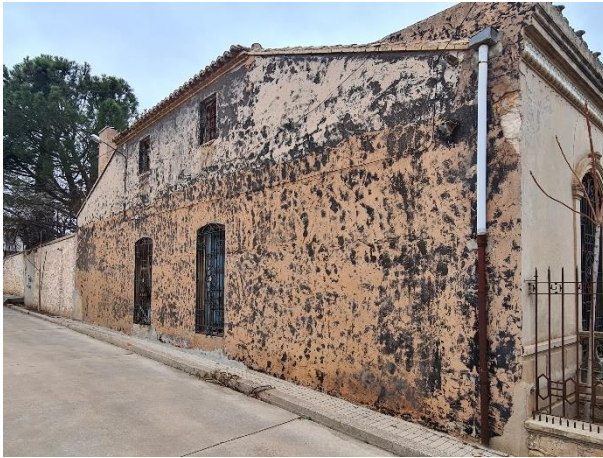
Figura 83. Paramentos exteriores con fisuración general. 2023. Fuente: propia
