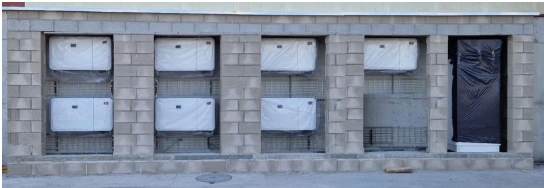
Figura 26. Caseta para inversores: Fuente: Indertec S.L
