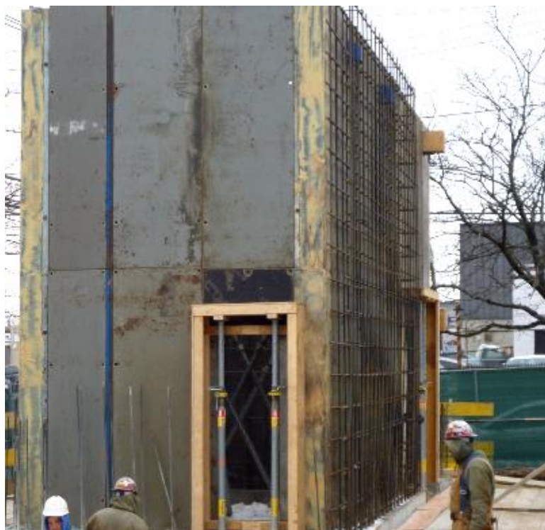
Figura 7: Ejemplo de muro vertical de hormigón armado Fuente: elaboración propia de un ejemplo de obra de otro proyecto
