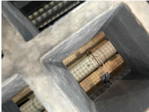
Figura 20: Tubería ancha (agua bruta) y tubería estrecha (hipoclorito).
