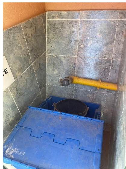
Figura 14: Tubería para la carga de hipoclorito, Paterna.
