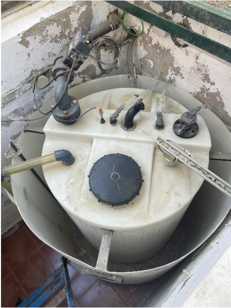
Figura 15: Depósito de hipoclorito, Paterna.
