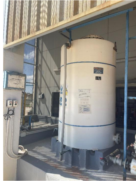
Figura 16: Depósito de hipoclorito, L'Eliana.
