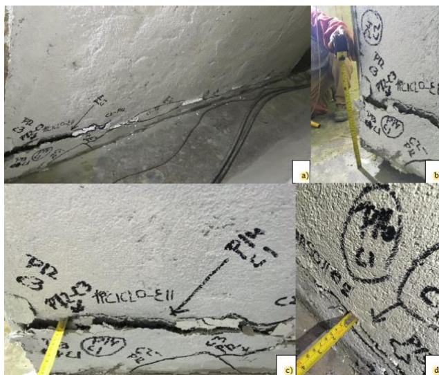
Imagen 5.13. a) Fisuración a largo de la base del muro. b) Levantamiento de 10cm en la base del muro. c) Desprendimiento del recubrimiento del muro en la esquina inferior. d) Desprendimiento del recubrimiento (0.5 cm) en la parte central inferior del muro.
