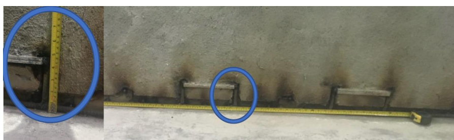
Imagen 5.12. Detalle de la base del muro C, varilla longitudinal y vástagos verticales
