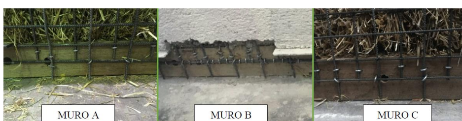
Imagen 5.11. Detalle de la cantidad de grapas en los muros A, B y C
