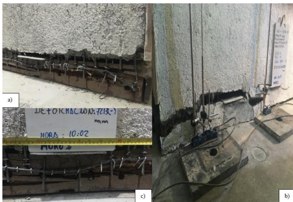
Imagen 5.17. a) Rotura de la escalerilla inferior. b) Evidencia de la separación de la escalerilla inferior con el resto del muro. c) Deformación de la varilla de 12mm a lo largo del centro del muro (en una longitud de 25 cm) y rotura de la malla de refuerzo.
