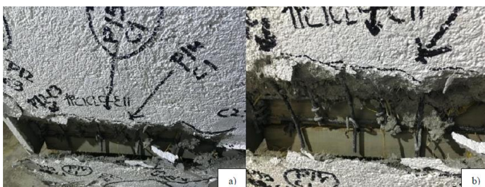
Imagen 5.14. a) Falla a cortante en la escalerilla inferior. b) Rotura a cortante de la escalerilla inferior y desprendimiento de las grapas de anclaje
