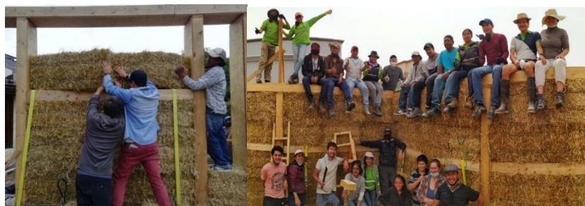
Imagen 6.24. Levantamiento de muros y participantes en construcción de la casa San Rafael.
