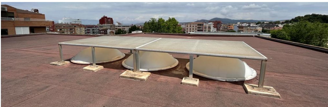
Figura 16. Estado actual del protector y claraboyas.
