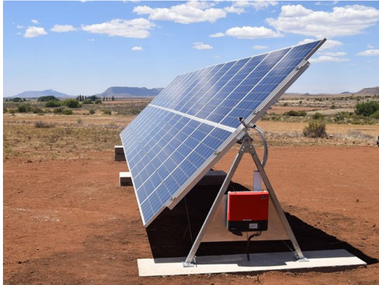
Figura 3. Ejemplo de panel fotovoltaico inclinable en un único eje automático.
