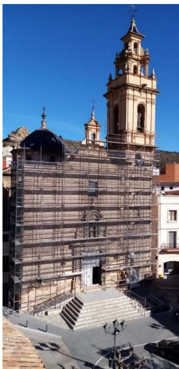
Fig. 4. Restauración de la fachada de la Iglesia Parroquial de Nuestra Señora de los Ángeles
