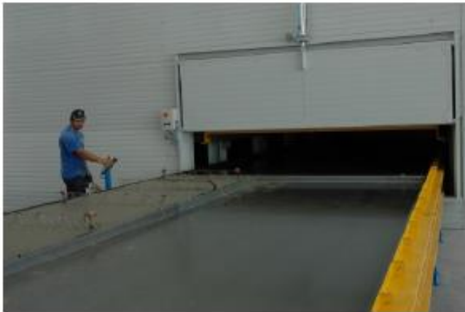
Ilustración 67. Cámara de curado. www.prefabricadoscanal.com
