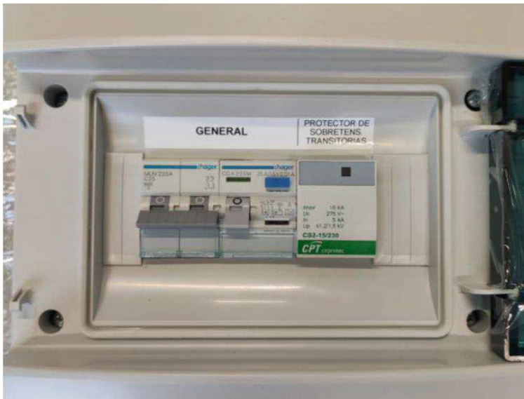
Imagen 27: Cuadro protección AC. Fuente SOLVER
