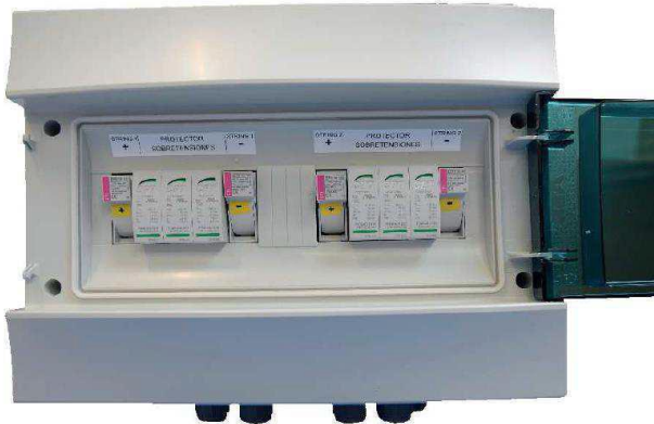
Imagen 26: Cuadro protección DC. Fuente SOLVER
