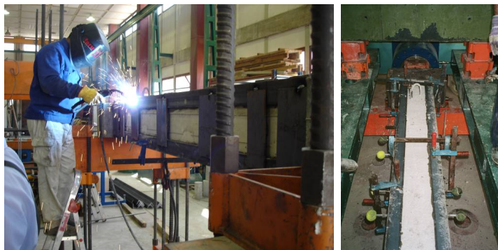
Fig. 3.8. Ejecución del refuerzo en el exterior (probetas ADa; BD; ADb; MAD; MBD; PAD; PBD) e interior (probetas AC; BC; MAC; MBC; PAC; PBC) del marco
