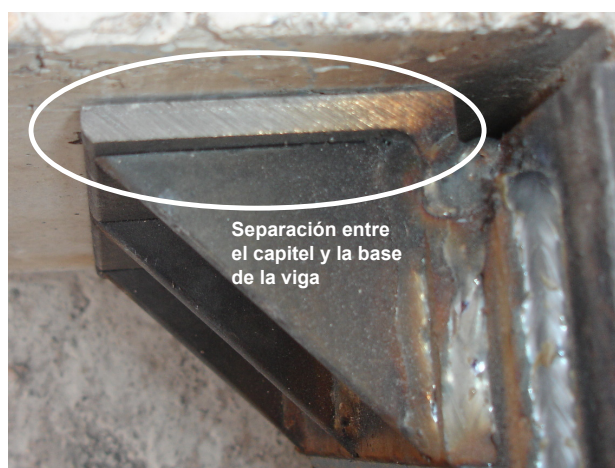
Fig. 4.10. Separación entre el capitel y la base de la viga debido al enfriamiento del primero después de la soldadura
