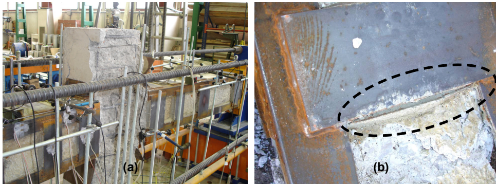
Fig. 5.40. (a) Fisuración en la viga central, previa a la rotura de la probeta. (b) Deslizamiento entre el mortero de cemento y los elementos del refuerzo
