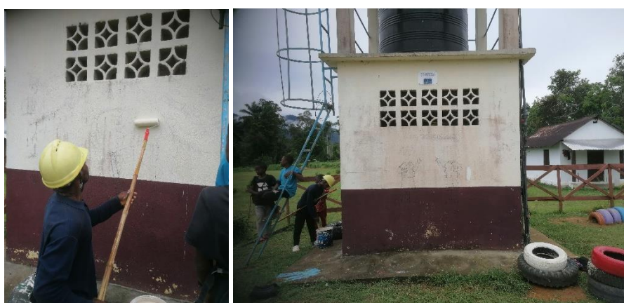
Ilustración 65: Pintura fondo muro. Fuente: Propia.
