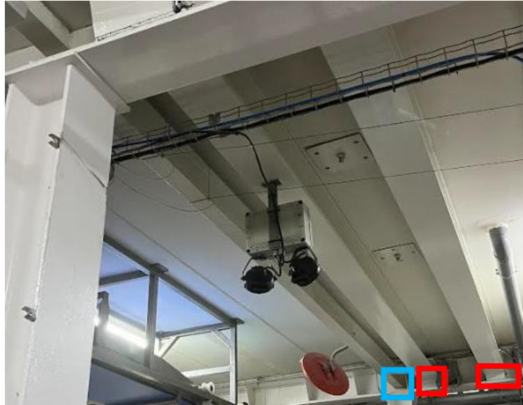
Figura 31. Apoyos y refuerzos que se encuentran actualmente en el forjado.
