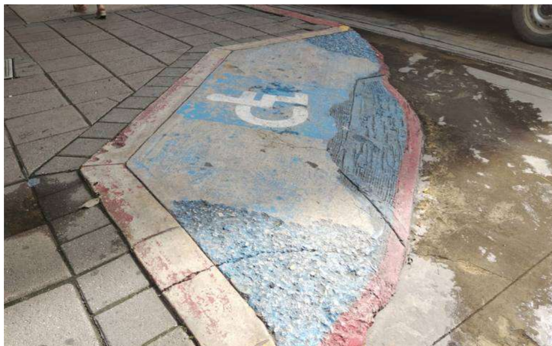
Figura 5. Rampa de acceso que cumple la normativa, pero es insuficiente para los requisitos mínimos de confort. Isaí López. https://www.elheraldodechiapas.com.mx/local/en-pesimas-condiciones-las-rampas-para-discapacitados-en-tuxtla-gutierrez-8855988.html
