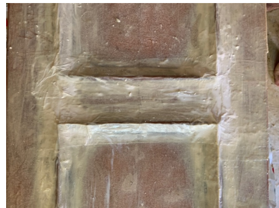
Ilustración 149. Refuerzos de las uniones de la fibra de vidrio con tela y látex.
