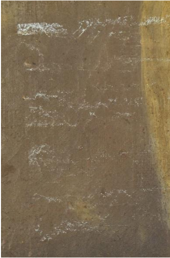
Figura 54. Restos de yeso de la pared sobre el anverso
