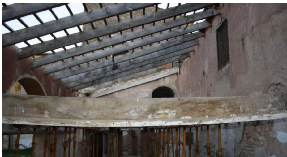
Imagen 50. Detalle de la cubierta a una agua que se encuentra en mal estado (12)
