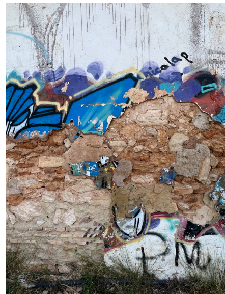
Imagen 17. Vista de los muros de la estructura resistente desde el exterior, Septiembre 2023 - fuente propia
