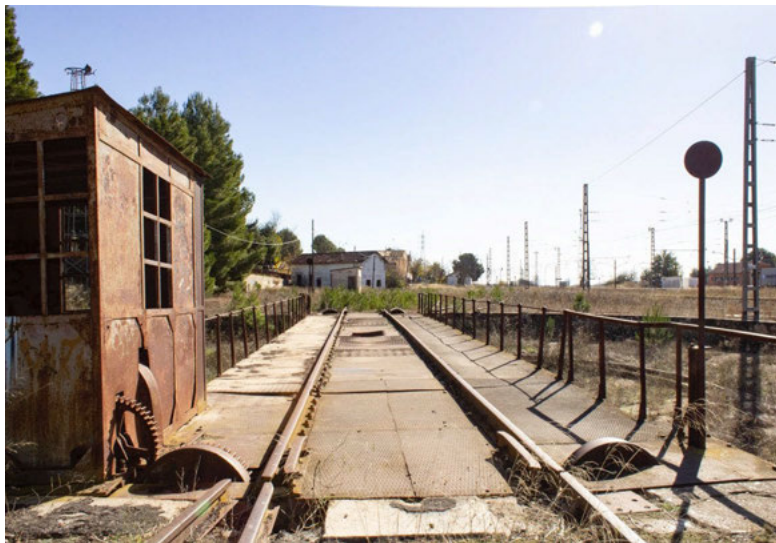
Fig. 4 Estado actual del puente giratorio. García López de A., V (2020)
