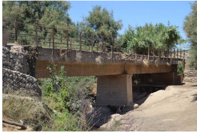
Fig. 5 Puente abandonado sobre el río Víboras, en un tramo fosilizado de la carretera A-316 cerca de Alcaudete (Jaén)
