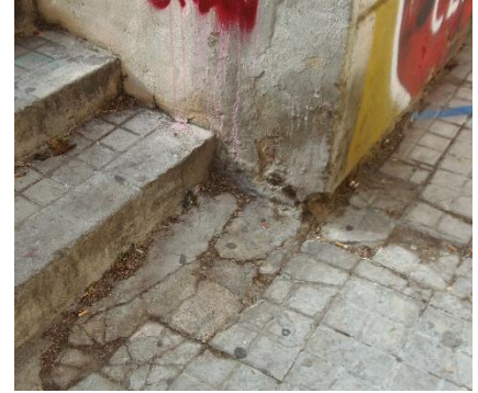
Imagen 4.3.21. Estado de la escalera del tramo 3.
