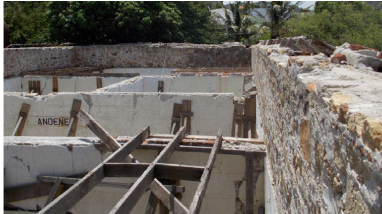
Fig. 5 Vista del muro perimetral y muros interiores de la estación. Archivo de investigación del autor (2018)
