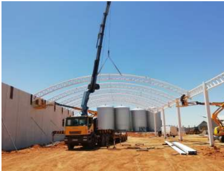
Ilustración 38. Camión autocargante. Fuente: Propia.
