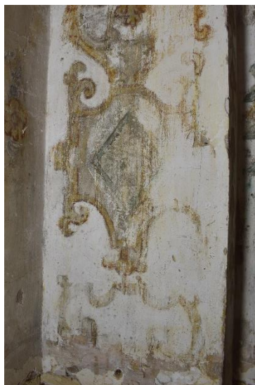
Figura 25. Detalle de una pilastra donde se aprecian los daños producidos por la cera de velas en la pintura mural.
