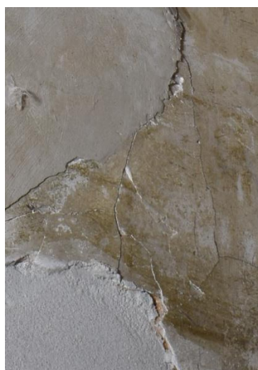
Figura 29. Pequeñas fisuras de carácter superficial.
