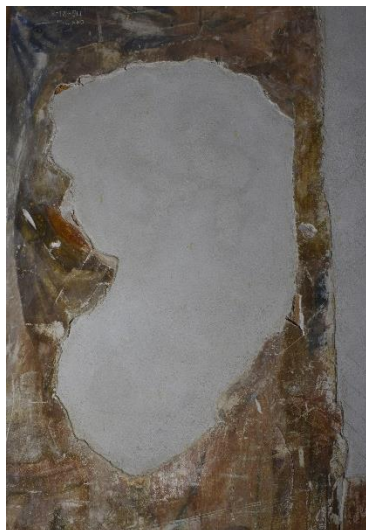
Figura 27. Laguna de grandes dimensiones con pérdida de mortero.
