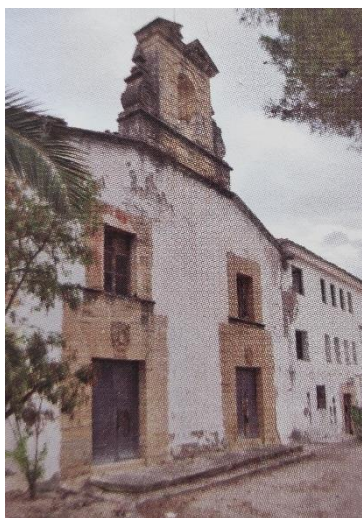
Figura 3. Estado de la fachada principal en 2010. Fotografía de Arcadi Piera.
