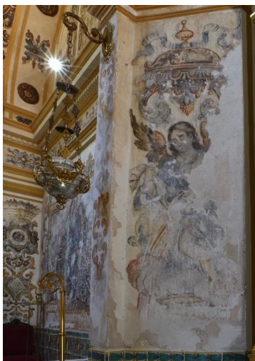
Figura 21. Detalle de la pintura mural de las pilastras en pésimo estado de conservación.
