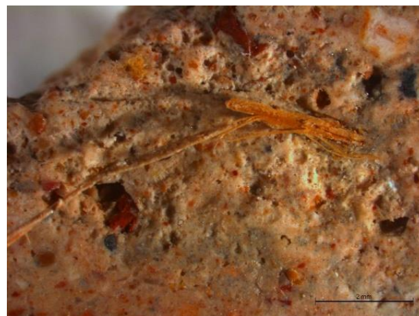
Figura 17. Detalle del mortero de yeso donde se observan impurezas arcillosas y fibras vegetales.
