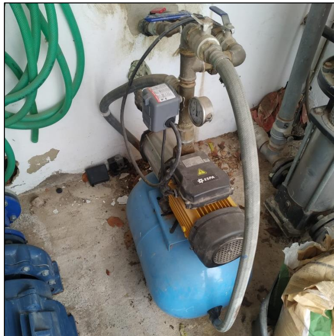
FIGURA 23. BOMBA PARA PRESIÓN DE VESTUARIOS DE LA PISCINA.
