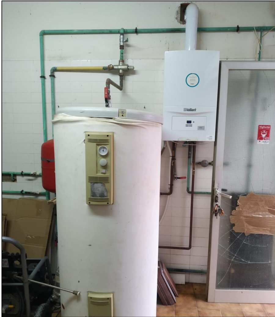
FIGURA 15. CALDERA DE CONDENSACIÓN VAILLANT Y ACUMULADOR VESTUARIOS PISCINA.
