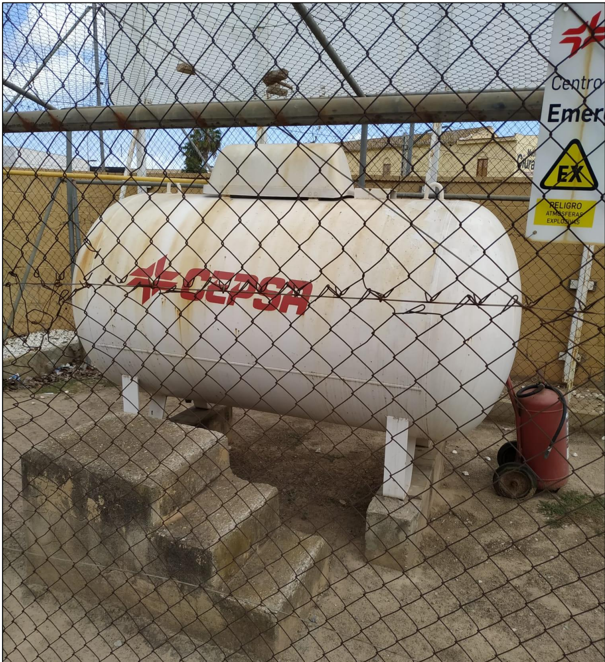
FIGURA 29. DEPÓSITO DE GAS PROPANO.
