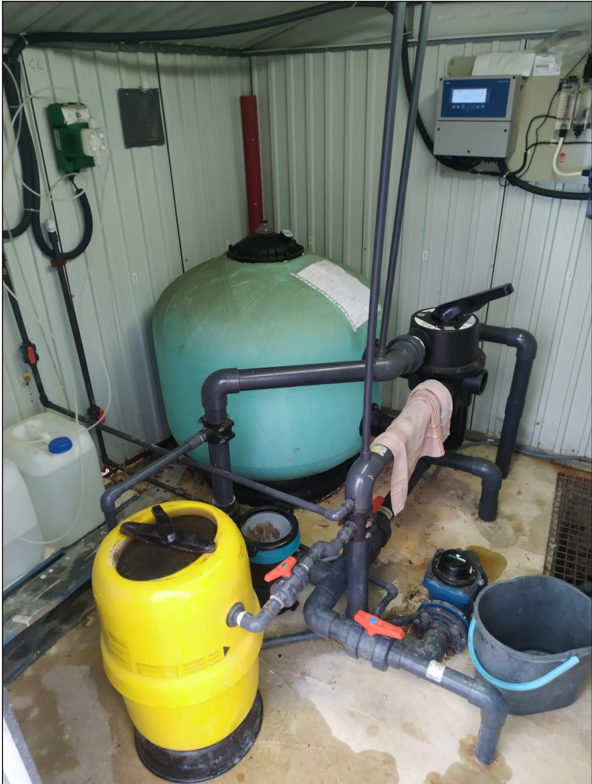
FIGURA 21. BOMBA DEPURADORA PISCINA PEQUEÑA.
