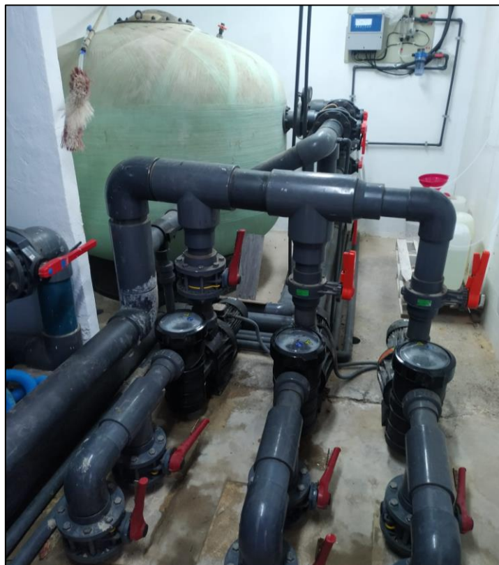
FIGURA 19. BOMBAS DEPURADORA PISCINA GRANDE.
