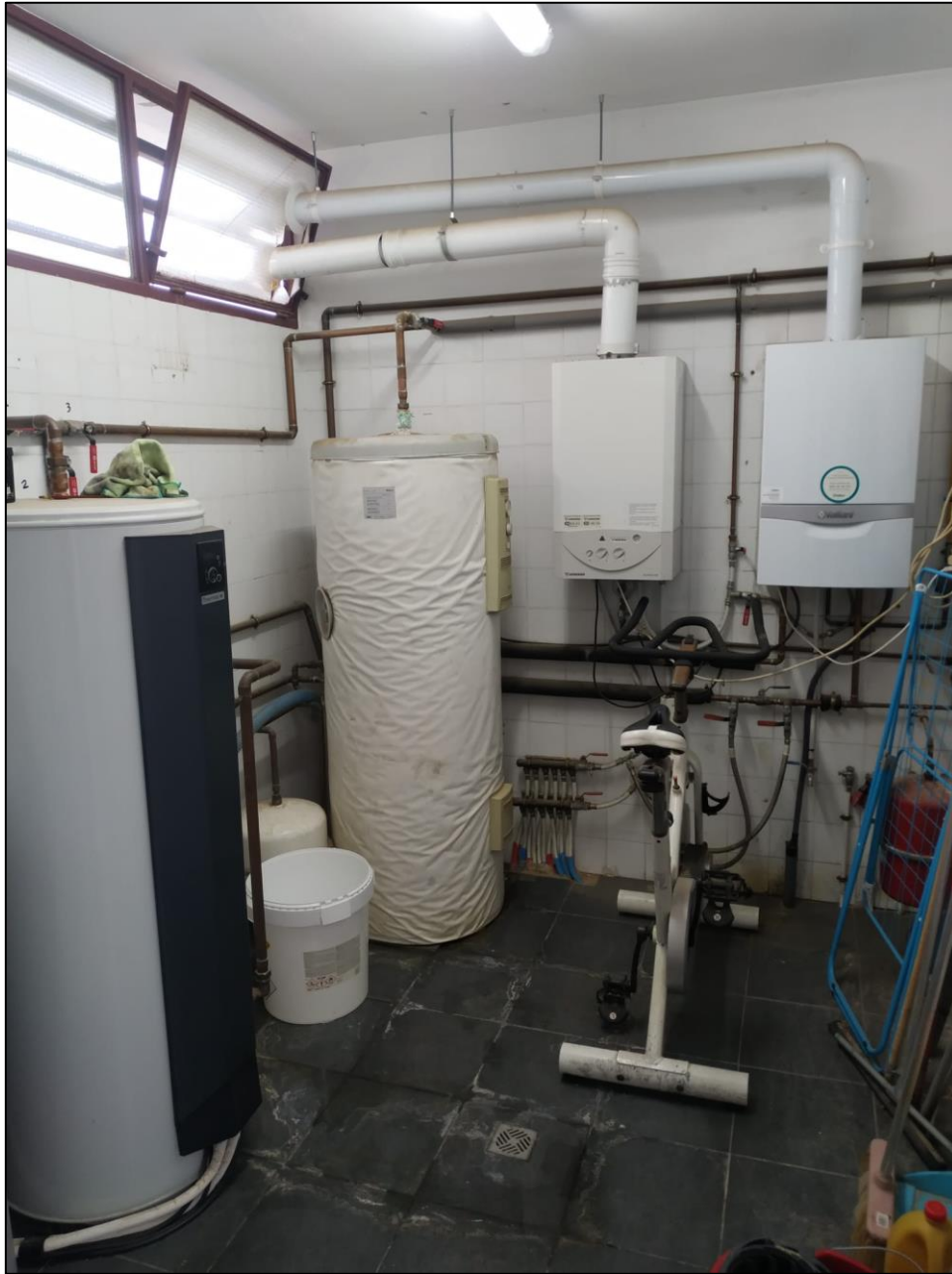
FIGURA 16. CALDERAS Y ACUMULADORES VESTUARIOS FÚTBOL.
