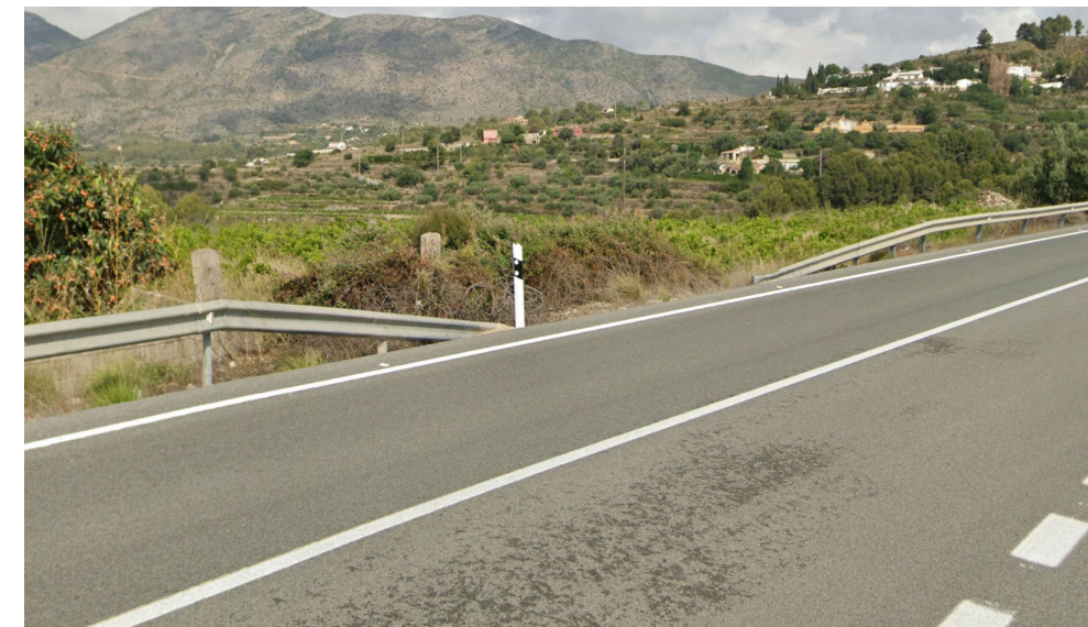
Figura 37. Separación incorrecta de barreras de seguridad entre el p.k. 174+785 y el p.k. 174+809 (Fuente: Elaboración propia)
