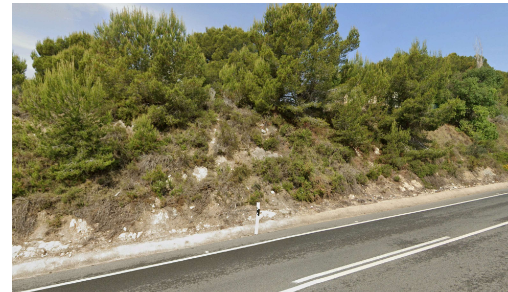
Figura 34. Desmonte en el p.k. 174+583 del tramo de estudio (Fuente: Elaboración propia)
