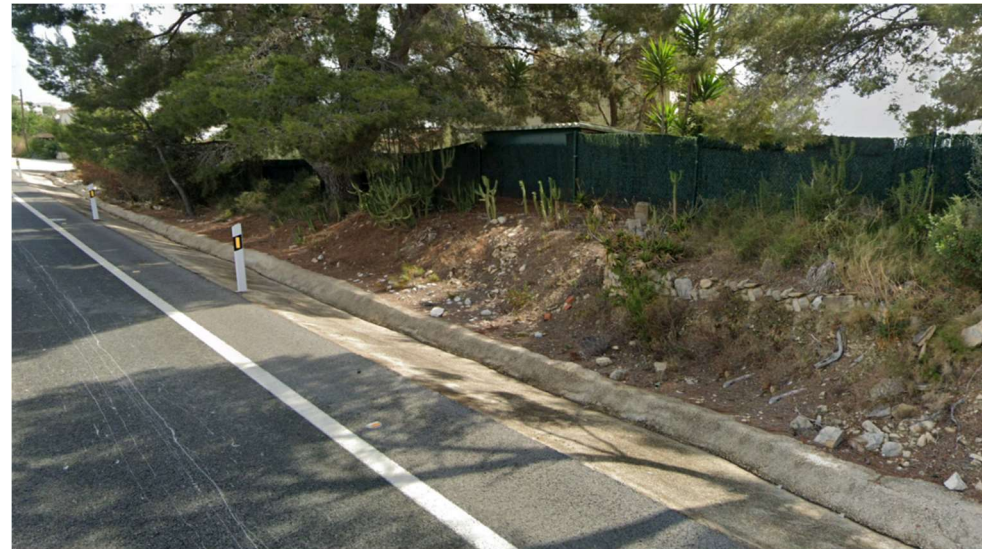
Figura 2. Arcén en el p.k. 174+093 del tramo de estudio (Fuente: Elaboración propia)
