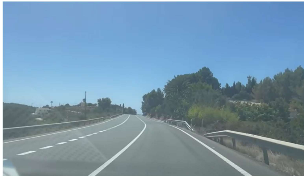
Figura 25. Separación incorrecta de barreras de seguridad entre el p.k. 174+785 y el p.k. 174+809, sentido decreciente (Fuente: Elaboración propia)
