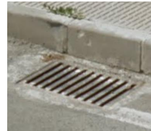
Figura 9. Drenaje actual del tramo 1. Fuente: Elaboración propia
