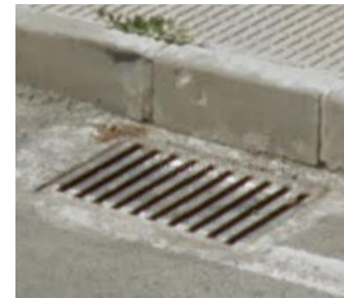
Figura 8. Drenaje actual del tramo 1. Fuente: Elaboración propia
