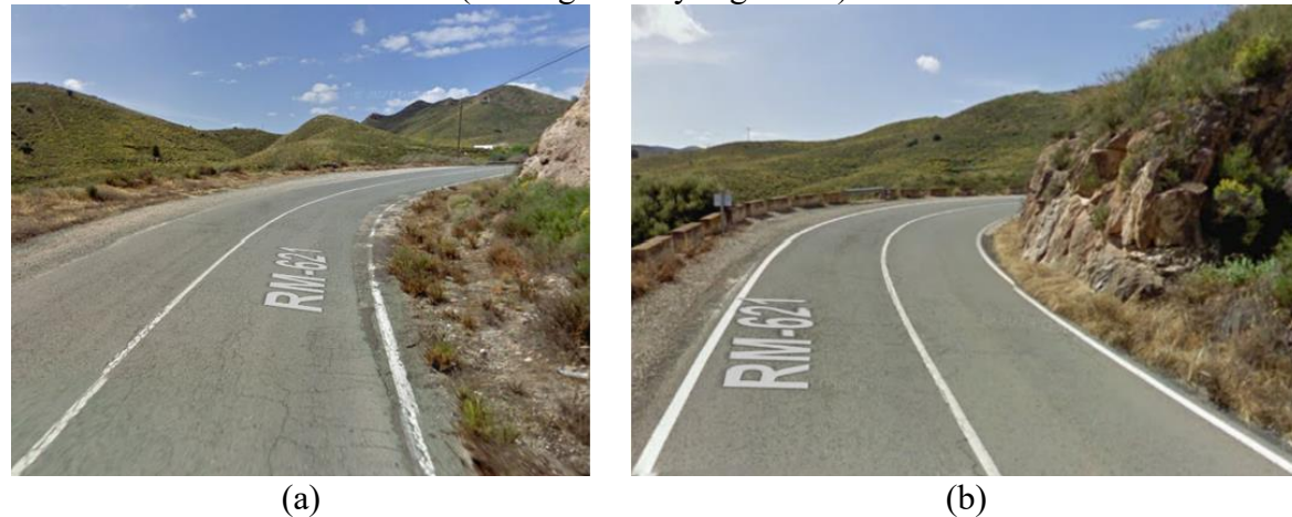
Figura 12. Curvas con visibilidad reducida en sentido creciente de PKs (a) PK 1+620 Y (b) PK 1+420. Fuente: Elaboración propia
