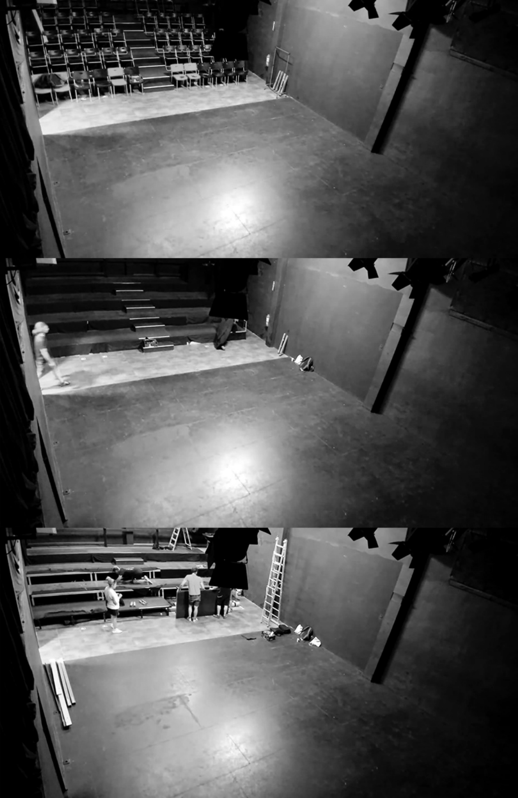
FIGURA 204. Proceso de desmontaje de gradas y nivelación del suelo para instalar la pista de hielo de «SÒL», 2022
