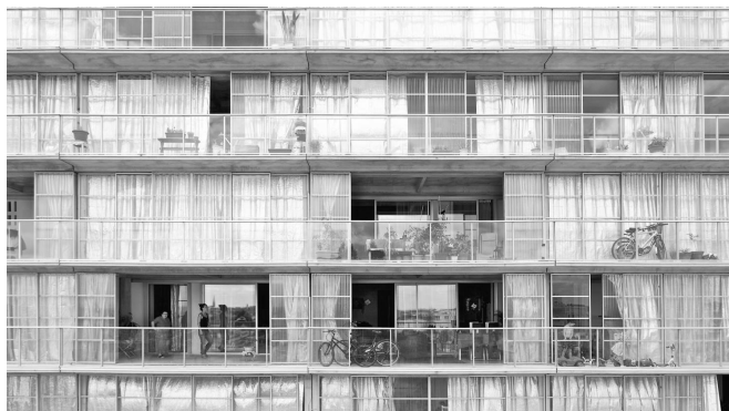
Fig. 96 Ampliación de crujía en viviendas de Cité du Grand Parc, Burdeos, 2016. Fig. 97 Crujía en bloque residencial en Burdeos, proyectada por Anne Lacaton y Jean Philippe Vassal en el 2016.
