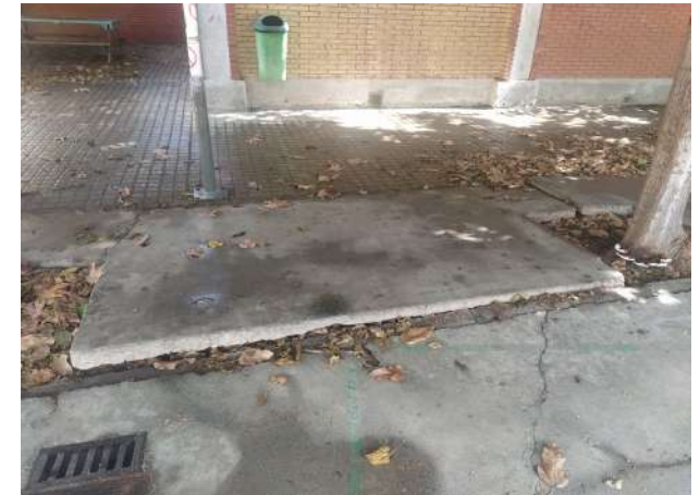
Fig. 71. Pavimentos en mal estado del patio del CEIP Pare Catalá.
