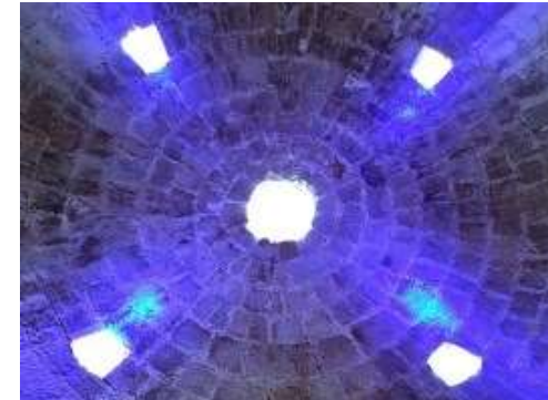
Bóveda del nevero de la cañada de Verich. Belmonte de San José (Alcañiz, Teruel). Siglo XVI.
