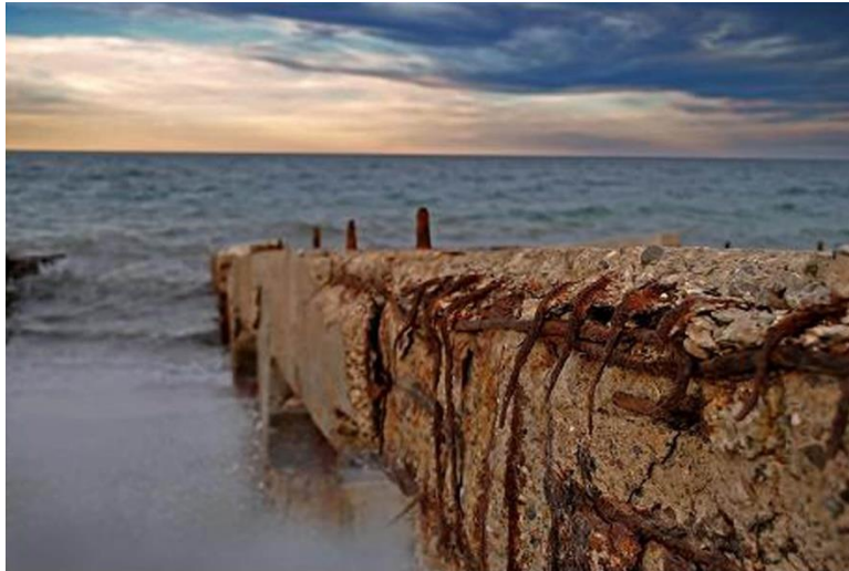
Figura 13. Corrosión por erosión en estructura marina. [23]
