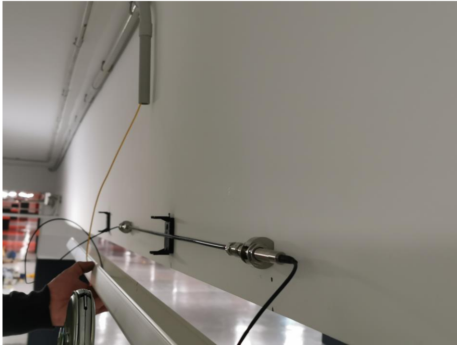
Figura 40. Sensor de deformación long- gauge emplazado
