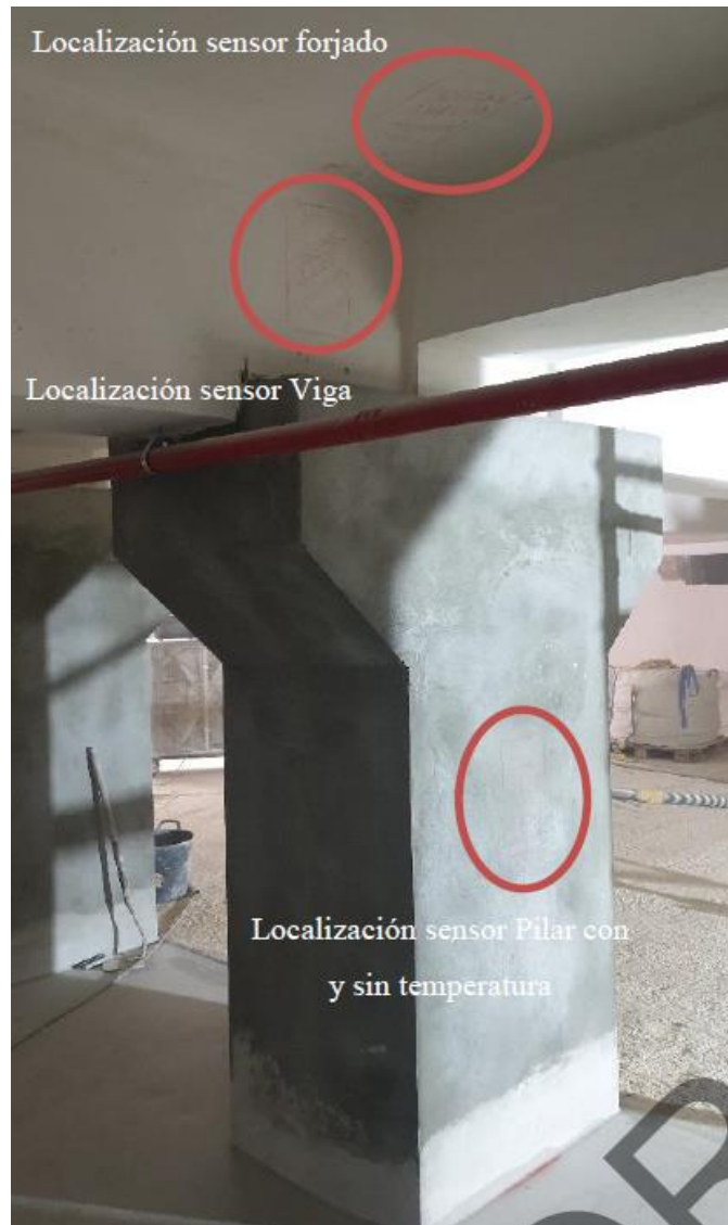
Figura 38. Localización de sensor de corrosión en forjado, viga y pilar
