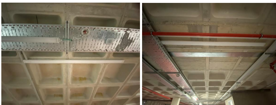
Figura 78. Sensores long-gauge instalados en la estructura.
