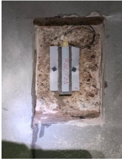
Figura 42. Sensor instalado en pilar en la planta -2 zona A
