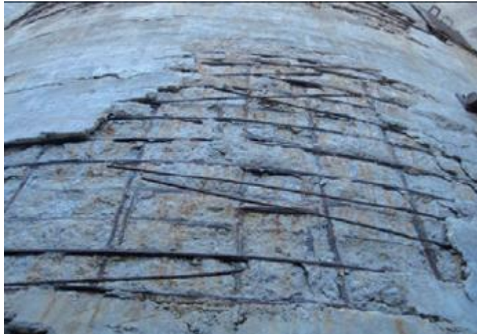
Figura 10. Corrosión uniforme en una columna de hormigón armado. [20]
