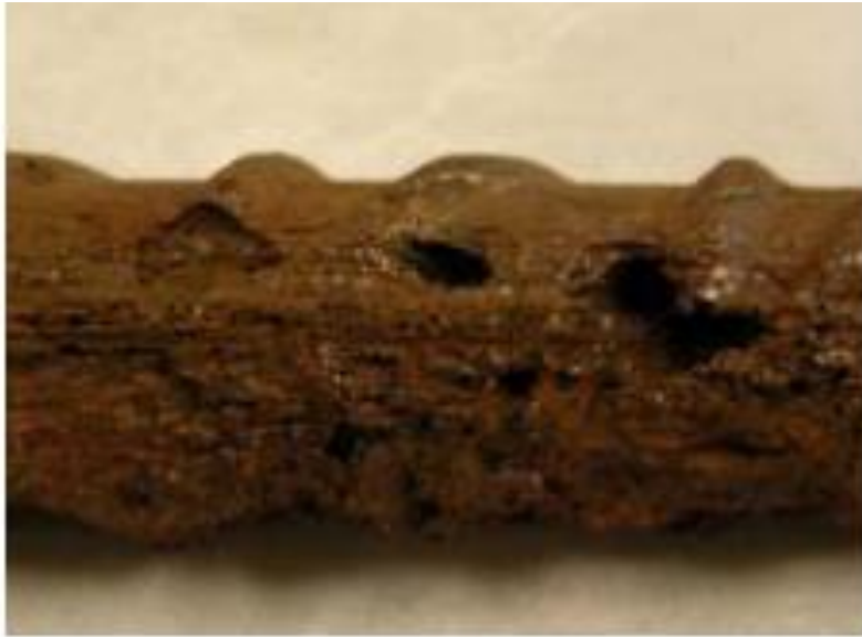
Figura 11. Corrosión por picaduras o pitting en el acero. (2016). Recuperado de: Apuntes asignatura Patología y Rehabilitación, “Efectos del ambiente marino en edificios de segunda residencia” [21]
