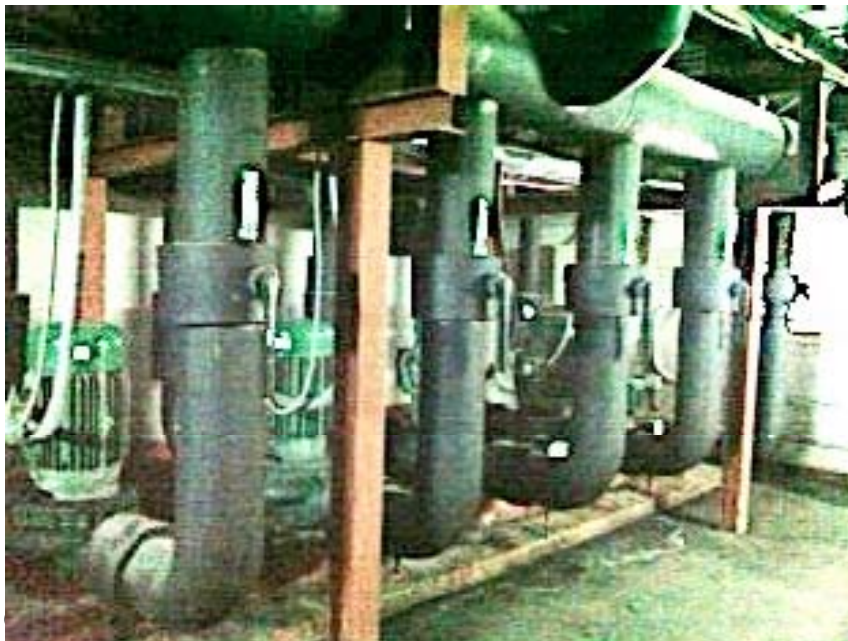
Detalle de colectores de retorno de climatizadores.
