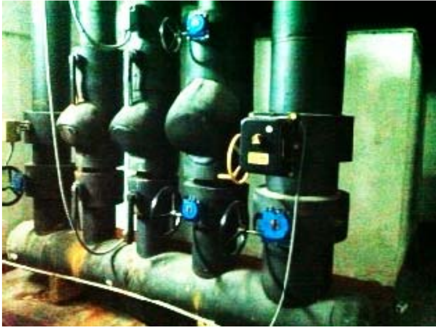
Detalle colectores de impulsión de impulsión, sala interior.
