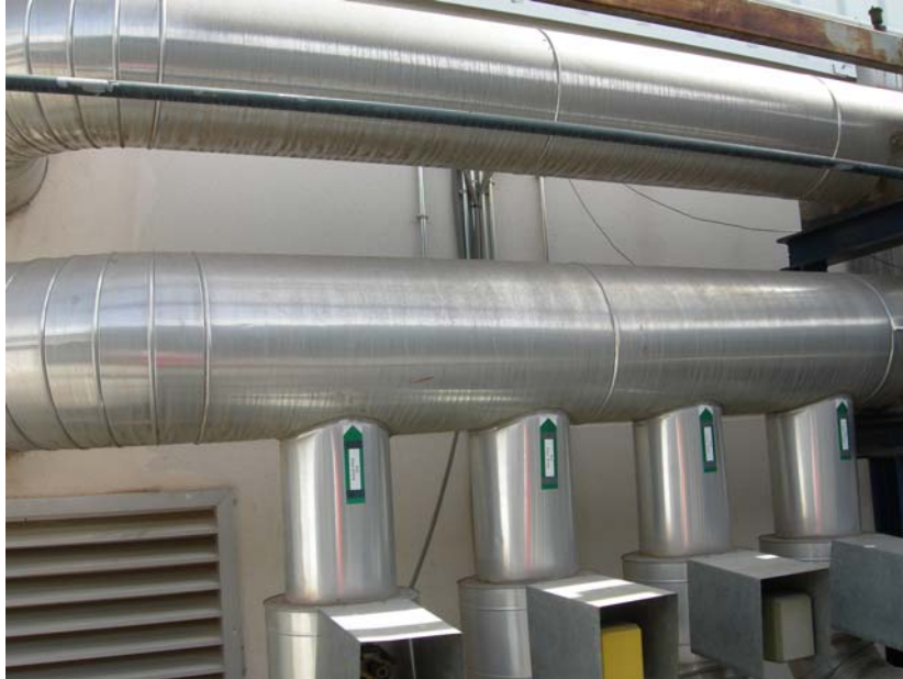
Colectores de impulsión de agua fría exteriores
