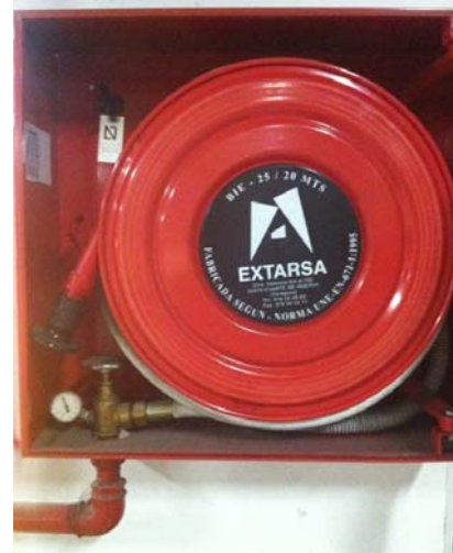
Boca Incendio Equipada
