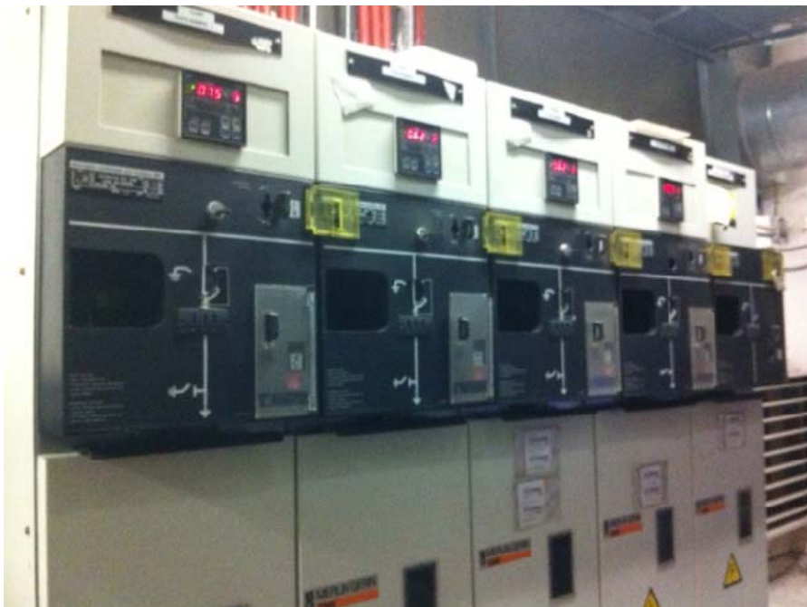
Detalle del cuadro general de sala de transformadores.
