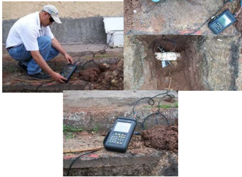
Figura N°44 Medición de caudales para la sectorización-
