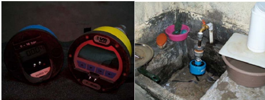
Figura N°43 Medición de presión.
