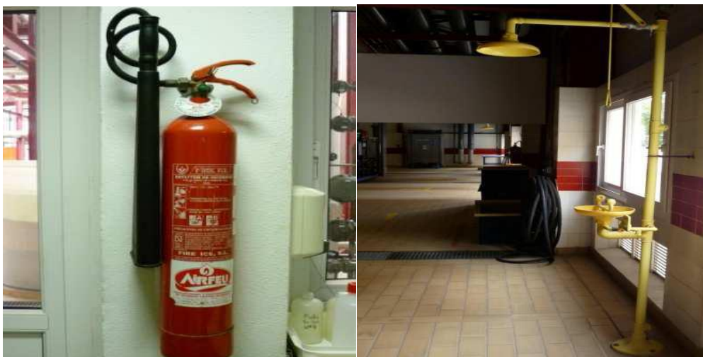
Figura 17. Extintor y ducha de seguridad (por cortesía de Heineken España S.A)
