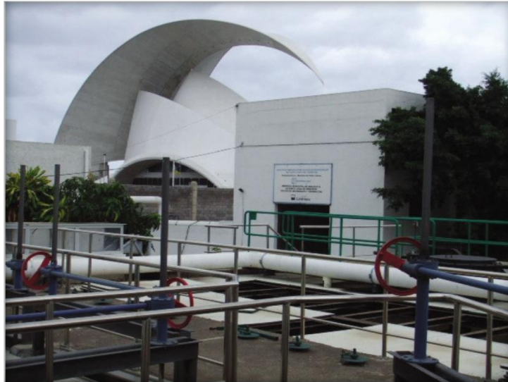
Imagen 7.1 "Estación de Pretratamiento y Bombeo de Cabo Llanos"
