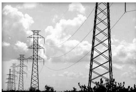
Imagen3.9 "Torres de línea eléctrica"
