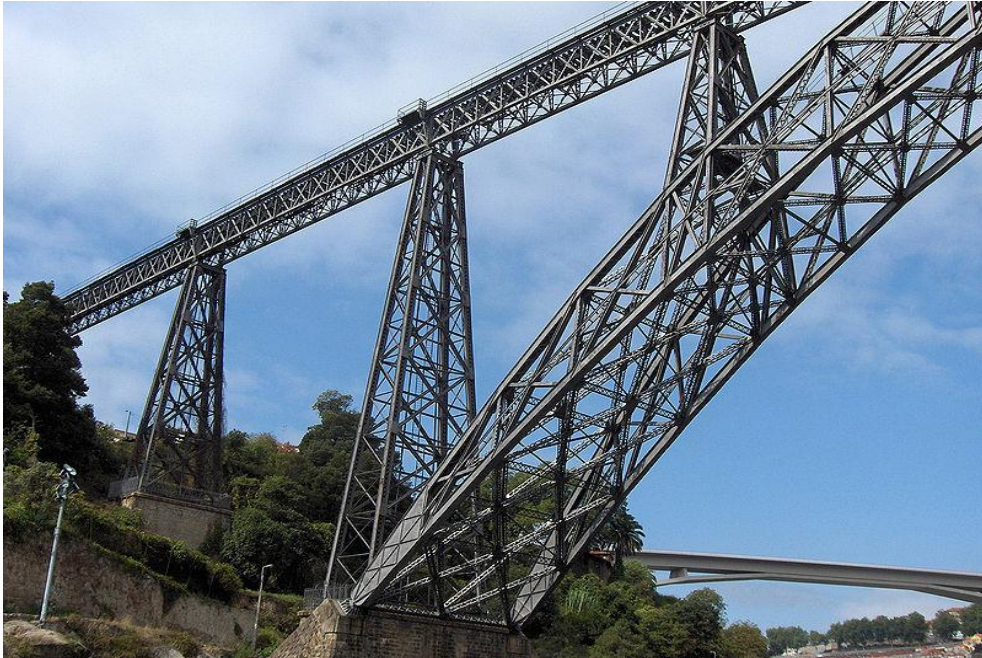
Fig. 4.45. Detalle de las estructuras trianguladas metálicas del arco, las pilastras y el tablero superior. (D. P.)
