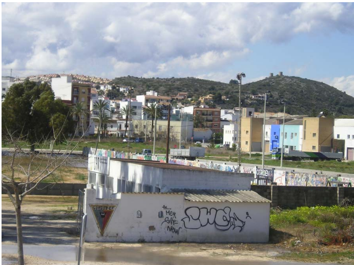
Foto d'una edificació a intervenir on antigament es trobaven els vestuaris dels equips, però que ara s'ha deixat abandonat i s'ha deteriorat molt. S'observa al fons del terreny la població de Gata de Gorgos.
